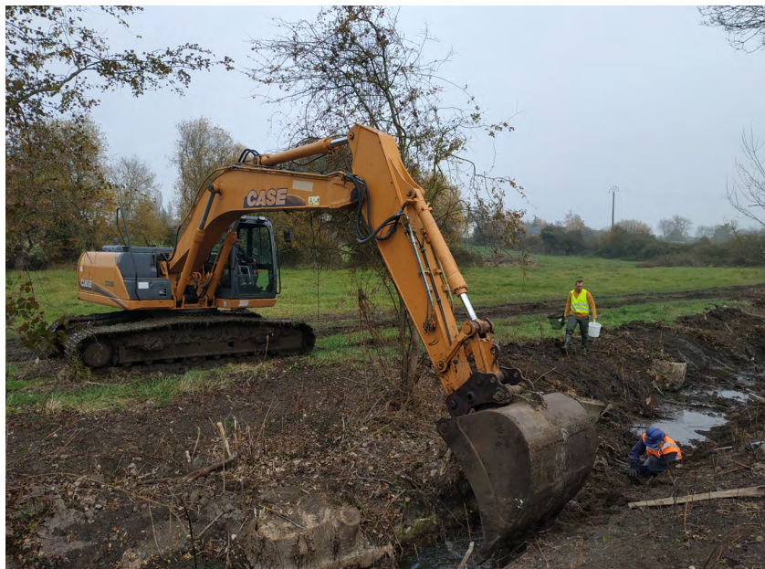
Exemple d'une mesure préconisée avant un comblement de cours d'eau : griffage avec capture de sauvegarde du Campagnol amphibie. © LPO Anjou
