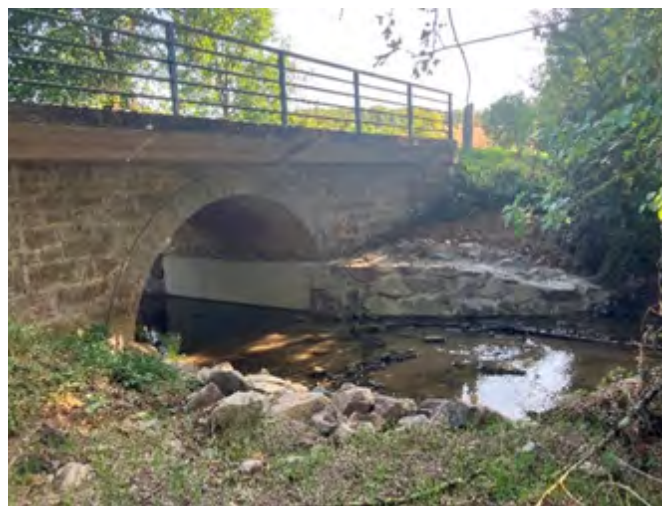
Figure 1 : Banquette béton avec enrochement, Metz-le-Comte (58) (@Justine Colinet)
